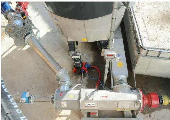
Bild 3: Der EnergyJet ist speziell für die Dosierung von NaWaRo sowie anspruchsvolleren Kofermenten wie zum Beispiel HTK in angemischter Form konzipiert.
