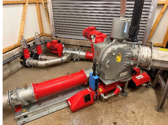
Bild 2: Das Feststoffdosiersystem PreMix bei H.A.N.S.-Energie GmbH & Co. KG im Einsatz. Das System vereint vier Arbeitsschritte in einer kompakten Einheit und bereitet anspruchsvolle, faserreiche Substrate zu einer homogenen Suspension auf.
